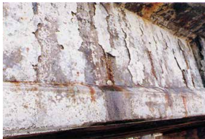
劣化の激しい橋げた
