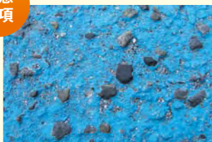
劣化が進行し、凸凹の激しいアスファルトの上に塗装すると凸凹が早期に磨耗し、美観と遮熱機能を低下させます。
